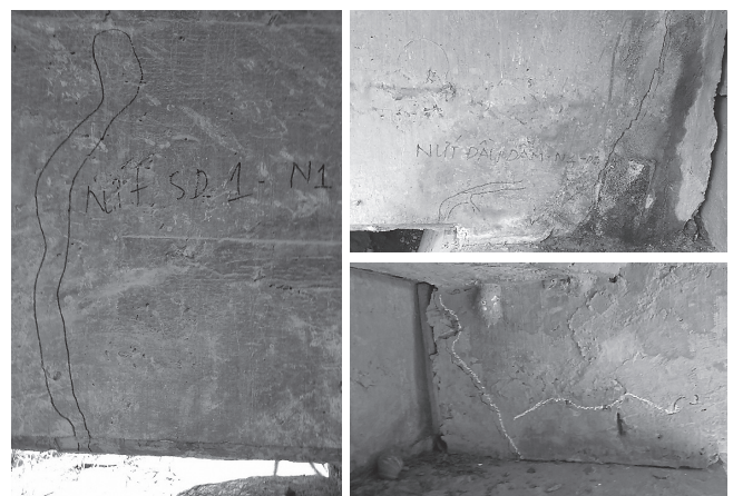
a) - Vết nứt ở khu vực giữa nhịp b) - Vết nứt ở khu vực đầu dầm
