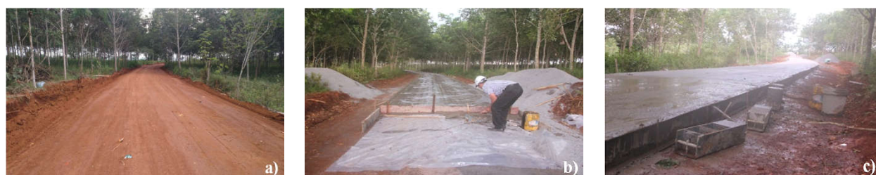
Hình 5: Một số hình ảnh thi công mô hình thử nghiệm. a) Lu phẳng bề mặt nền đường; b) Trải nilon, lắp ván khuôn; c) Đầm, san gạt và tạo phẳng bề mặt
