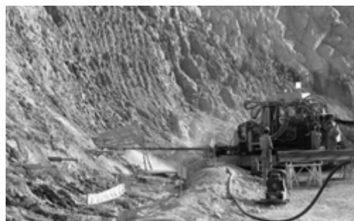
Hình 6. Hệ thống thoát nước mỏ và thi công các lỗ khoan tháo nước [4]
