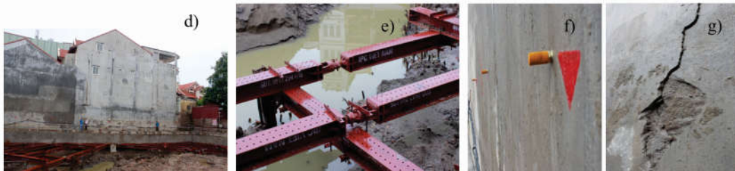
Hình 4: Một số hình ảnh hố móng. a) Văng chống tại vị trí công trình lân cận, b) Chuyển vị của tường khi đào xuống -2,5 m; c) Chuyển vị của tường khi lắp đặt thanh chống -2,0 m; d) Khảo sát tại vị trí công trình lân cận; e) Nước cuốn theo hạt đất mịn và cát vào trong hố móng; f) Bố trí các mốc quan trắc trên công trình lân cận, g) Nứt công trình lân cận
